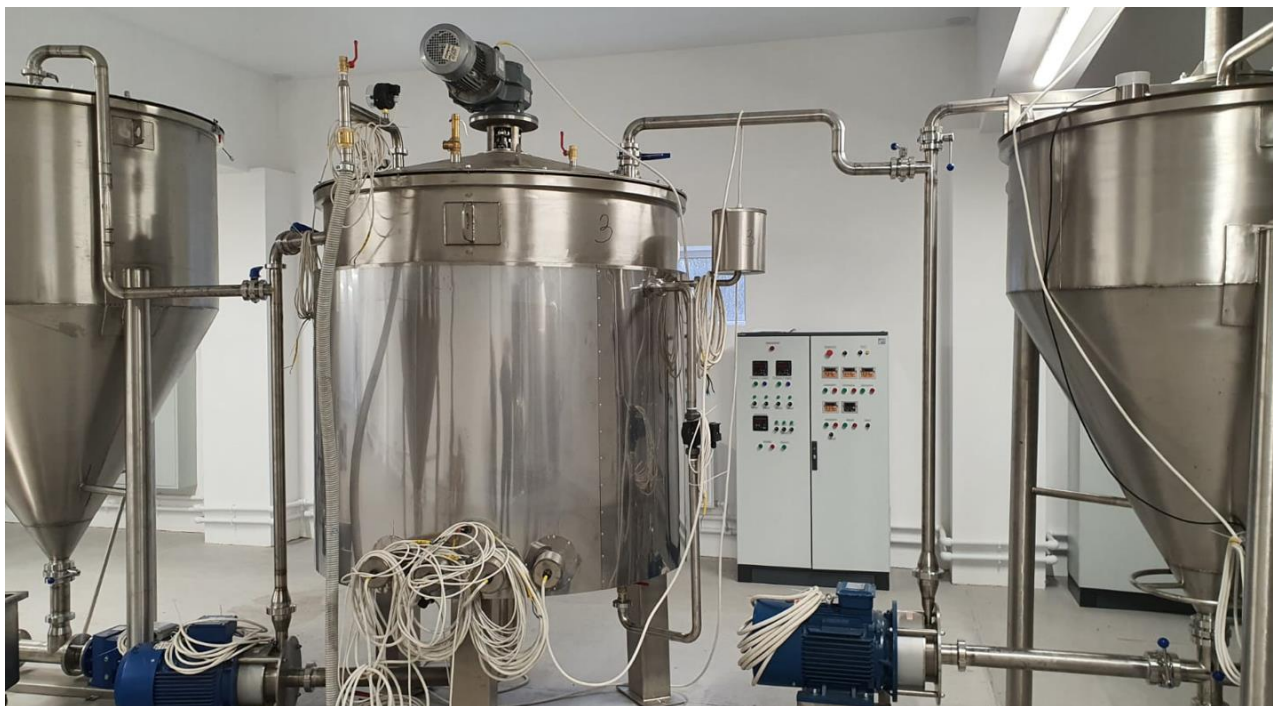
Рис.3.22. Вакуумный реактор, пульт управления
