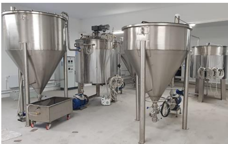
Рис.3.12. Первая стабилизационная колонна, вакуумный реактор узел подготовки, узел подогрева воды
